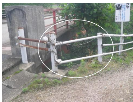
△側道防護柵の破損修繕
