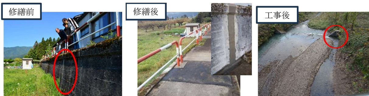
△大宮野団地の流雪溝継ぎ目からの漏水修繕(南砺市)
